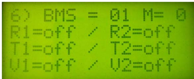
Fig. 8. Le menu 6 : l'état des entrées/sorties du BMS 1/2.
